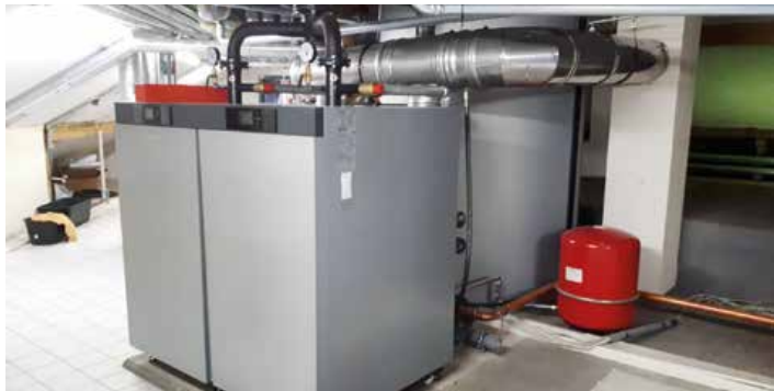
Die neue Heizungsanlage der Alexa-Residenz in Pirna
