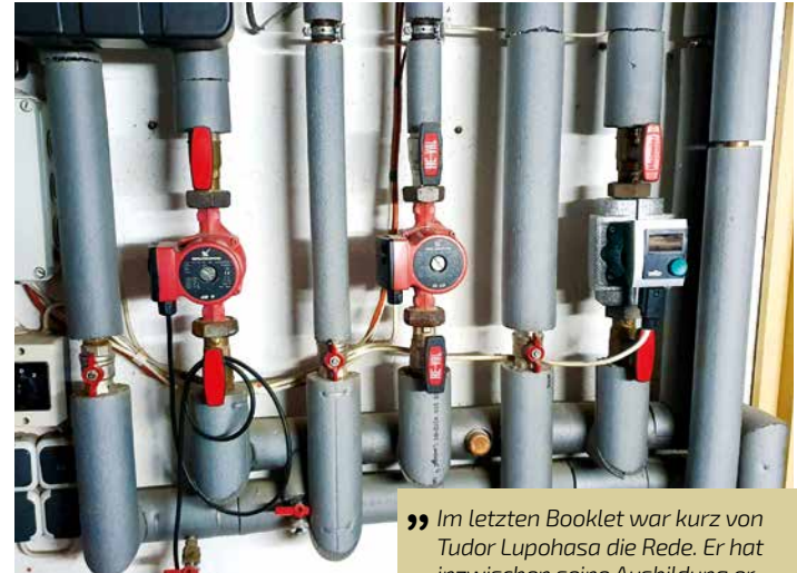
Verteiler der neuen Heizungsanlage
